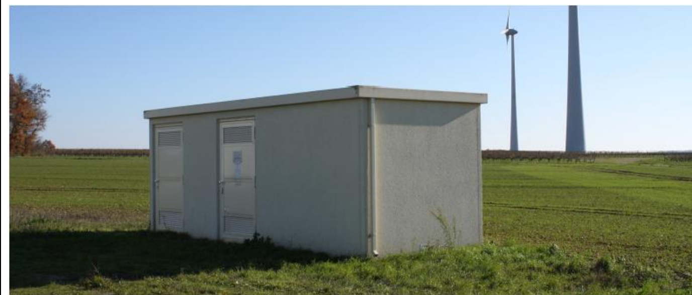
Exemple de poste de livraison (du parc éolien de Saint-Fraigne)
